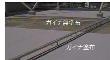
▲ RC 造建物屋上のガイナ塗布箇所とガイナ無塗布箇所の表面温度を計測。測定日：2008年9月3日 外気温：33℃
